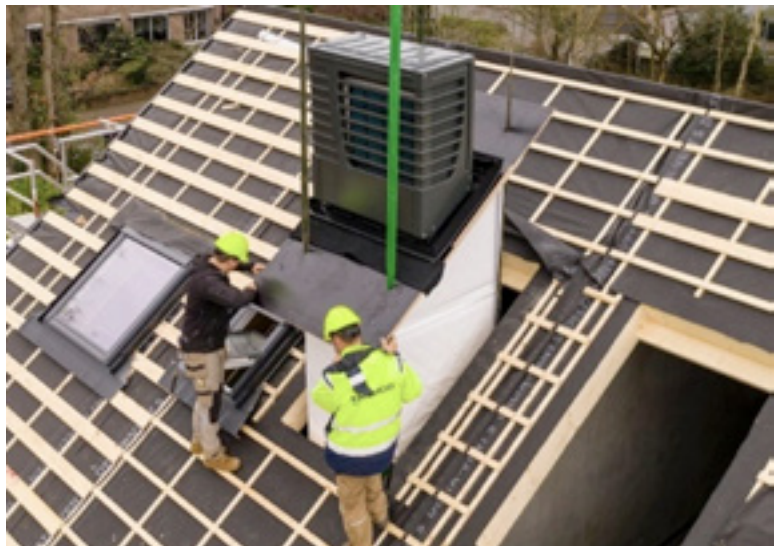
Energimodule (geproduceerd door Factory Zero). Bron: Jan Willen van de Groep
